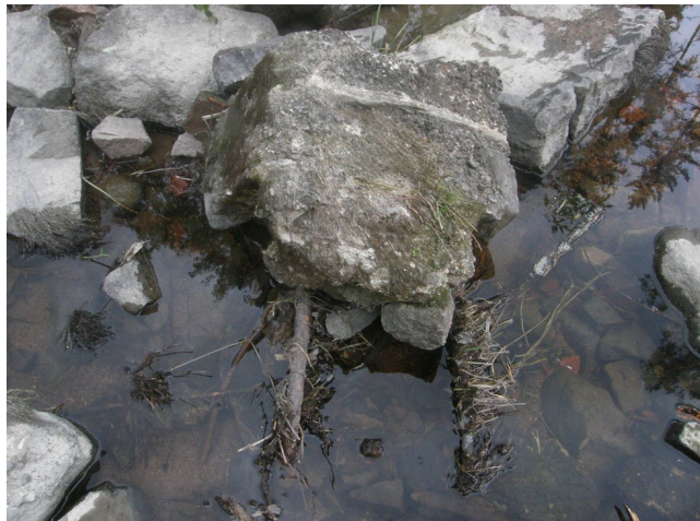
Kuva 18. Yksi päärakennuksen eteläpuolella olleen lisärakennuksen veden päällä olleen länsiosan kannatinpylväistä (lisärakennuksen länsiseinän alla ollut pylväs) kaatuneena joen pohjalla. Pylvään yläosa on pinnalta melko sileäpintaista betonivalua, mutta betonissa on käytetty täytteenä runsaasti pieniä luonnonkiviä. Pylvään alaosan betoni on rapautunut pois, ja jäljelle ovat jääneet vain etualalla näkyvät rautatangot. Rautatangot jatkuvat joen pohjan maaperään, missä pylvään alaosa on todennäköisesti tallella.
