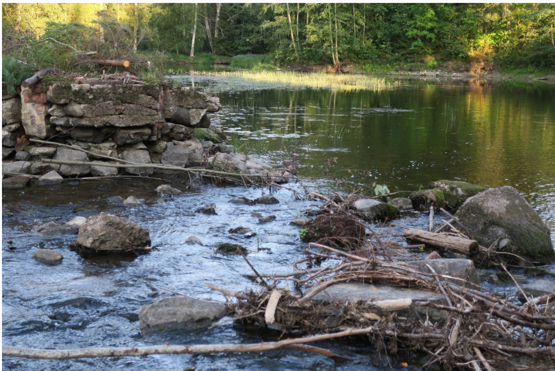
Kuva 20. Puuhiomon eteläisen lisärakennuksen eteläseinän alla olleet betonipylväät ja lisärakennuksen perustus elokuussa 2021. Kuvaussuunta on itäkaakkoon. Perustuksen alaosaista kaikki sen ulkopinnalla ollut betoni on rapautunut pois. Perustuksen yläosassa vielä oleva betoni on tyhjän päällä. Vertaamalla betonipinnassa olevien halkeamien muotoa vanhaan valokuvaan nähdään, että jäljellä oleva betonipinta on vanhassa kuvassa perustuksen läntisen sivun yläosassa, sen keskellä. Perustuksen luoteis- ja lounaiskulmat ovat rikkoutuneet pahasti. Lisärakennuksen eteläseinän alla olleet pylväät ovat kuvan oikeassa laidassa. Lounaiskulman alla ollut pylväs on itään kallistuneena jokseenkin samassa asennossa kuin vanhassa kuvassa. Sen ja perustuksen välissä ollut pylväs, joka vanhassa kuvassa on kallellaan, on kaatunut kokonaan.
